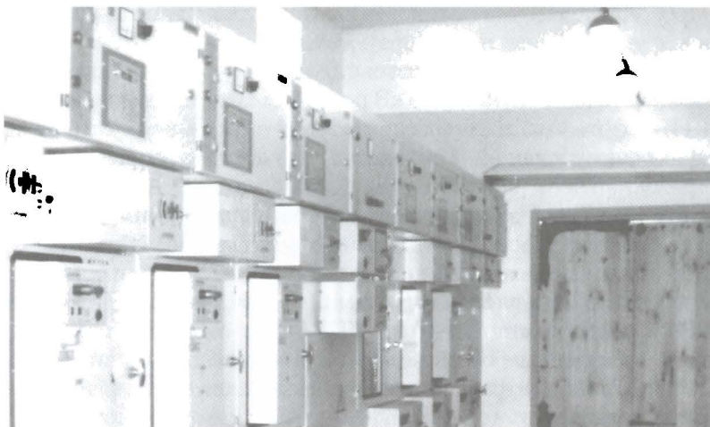
РП 10 кВ (угол ул. Советская - Брусиловского. 2006 год. После реконструкции).
