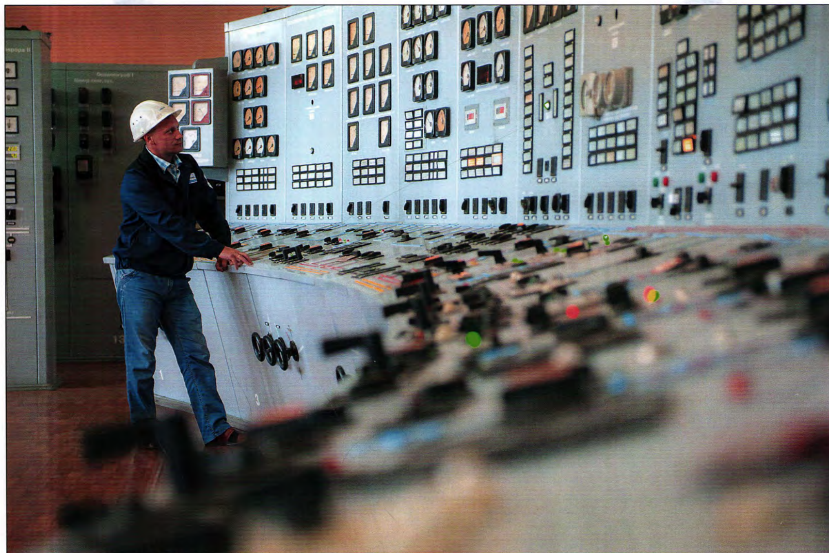
Главный щит управления ТЭЦ-2. 2013 год.
