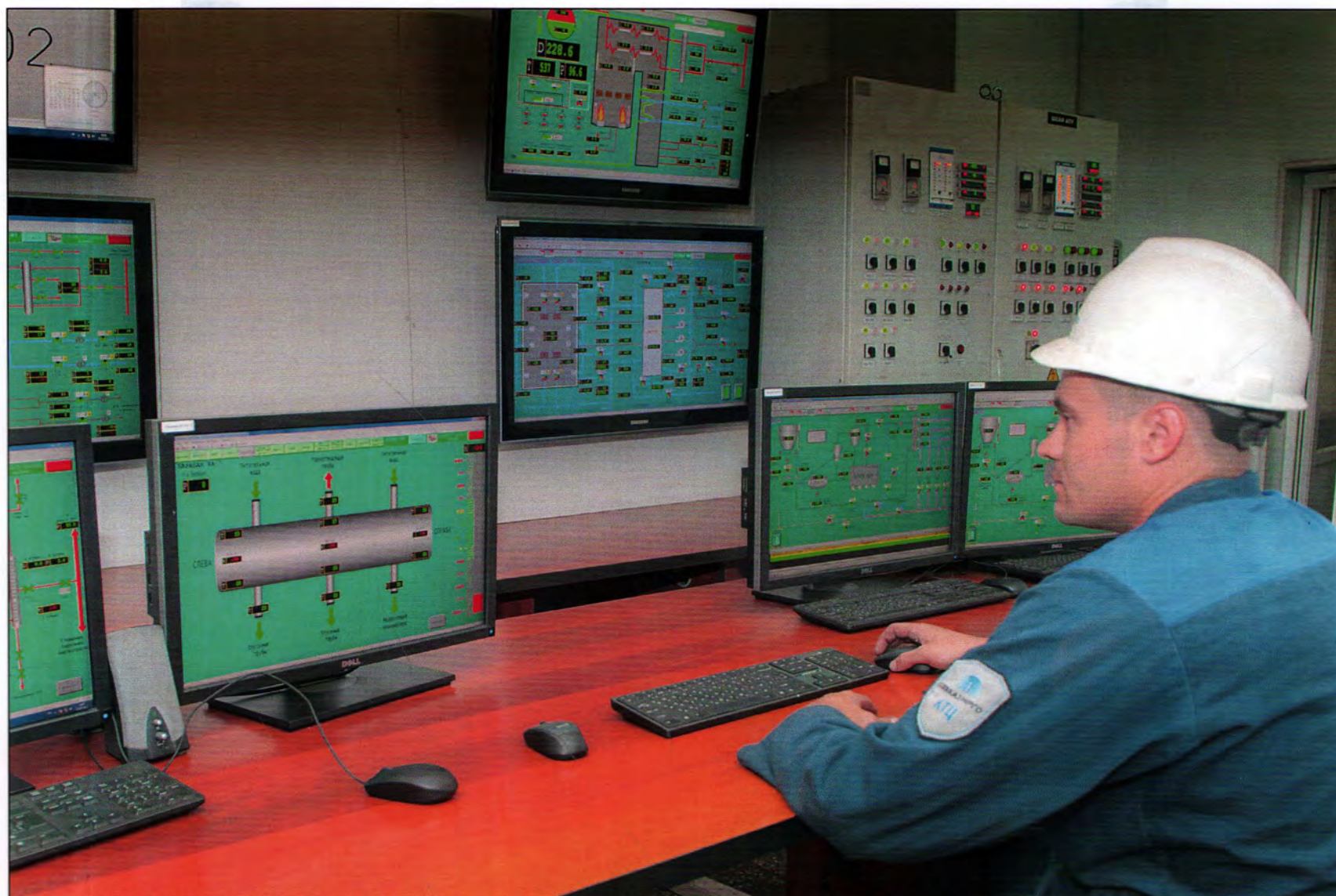
Щит управления котлоагрегатом № 8. 2013 год.
