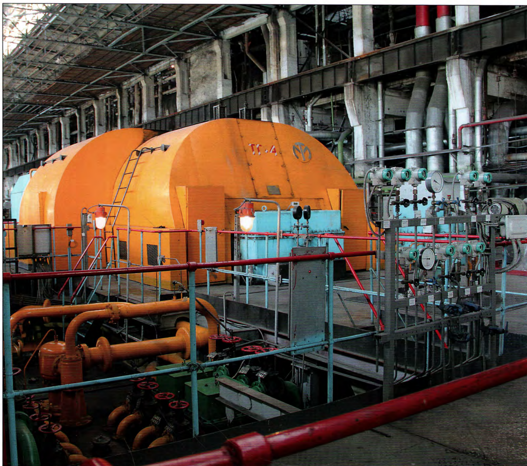
Турбогенератор № 4. Август 2015 года.
