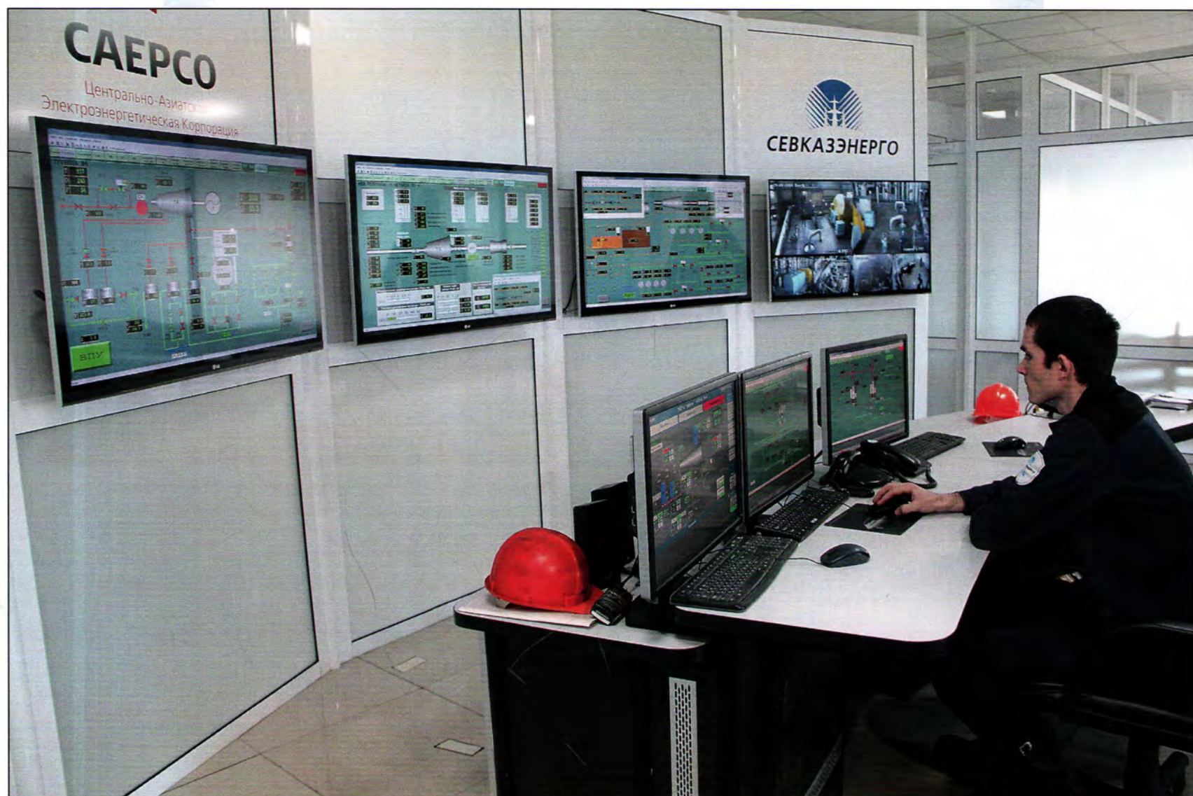
Щит управления турбогенератора № 4. Апрель 2014 года.
